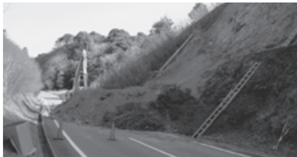
右：災害現場 (磯部町穴川地内)
