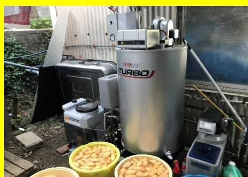
【新設した蒸気ボイラー】
