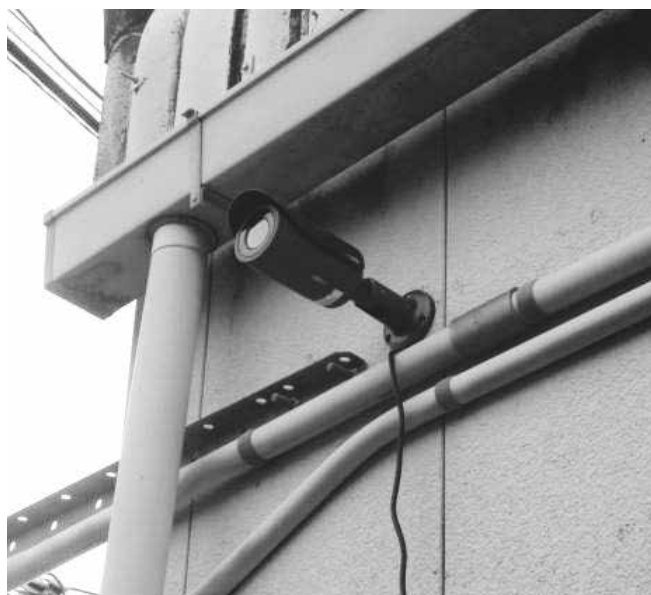
自治会と協力し市内ごみ集積所付近へ設置した監視カメラ
