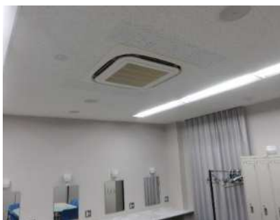
控室2空調設備
