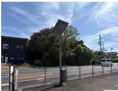
第2駐車場防犯灯
