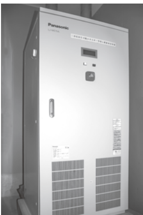
太陽光発電蓄電池
