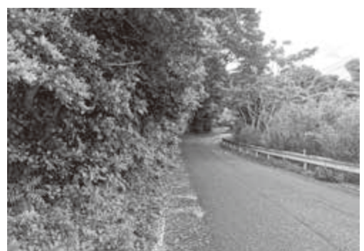
路線バスも通る市道（旧国道）を覆う支障木
