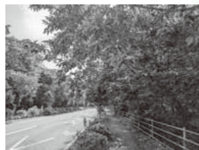
歩道を越えて道路まで伸びる樹木
